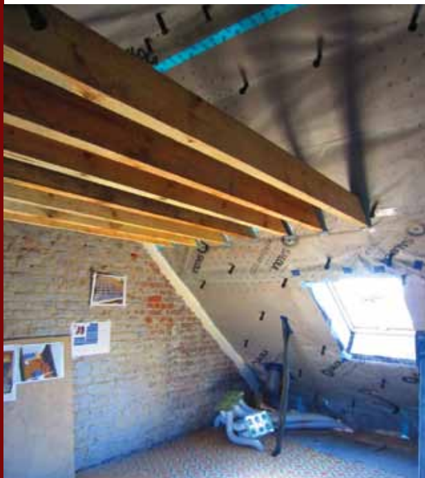
Mise en étanchéité parfaite entre les fenêtres de toit, les poutres mezzanine, les murs et autres passages de gaines (solaire thermique, VMC)
