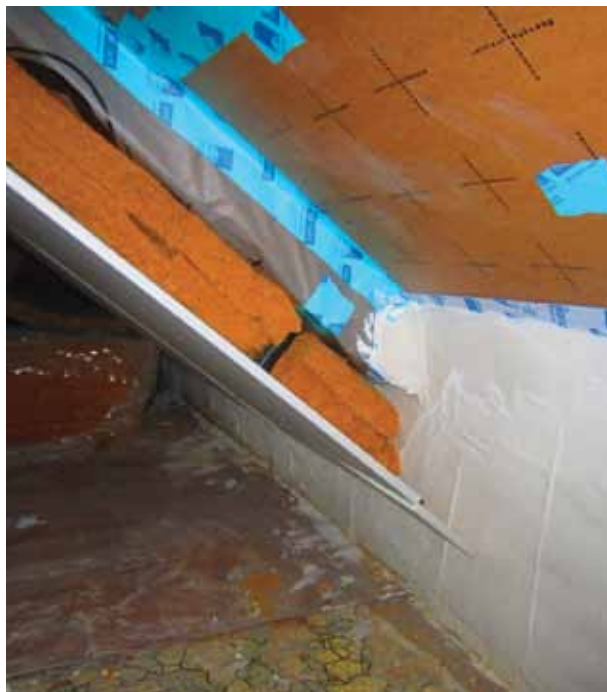
Petit détail important ! Mise en place au dessus de la trémie de l'escalier à la place de la laine de bois, des plaques de polyuréthane afin de gagner de la place pour le passage tout en étant performant (18 cm MPU, R=8,2)
