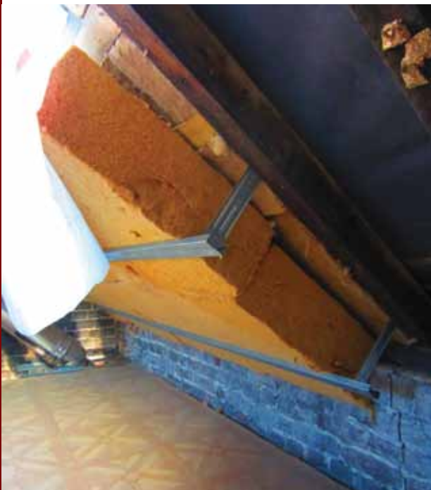
Mise en place de laine de bois (confort d'été), avec fourrure + suspente métallique, 8 cm entre chevrons + 16 cm en croisé... mais ce n'est pas fini !
