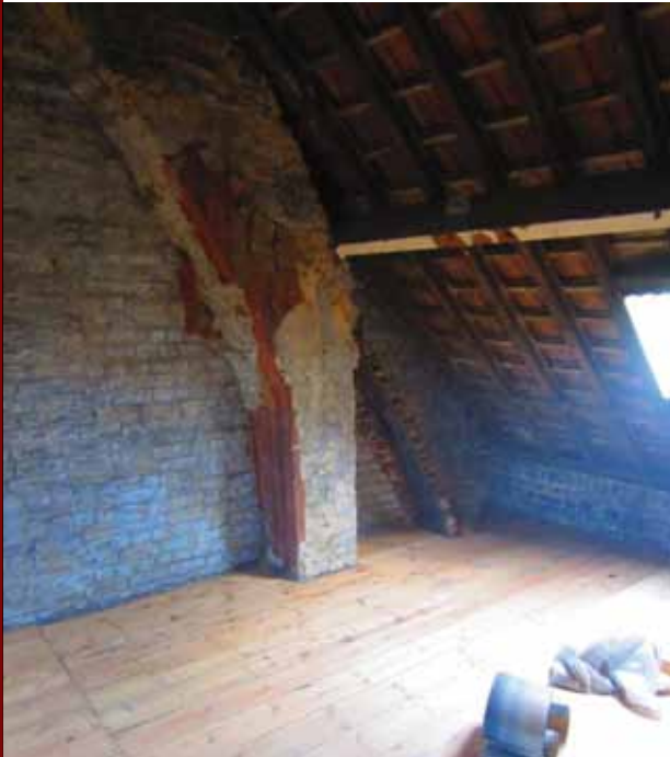
Etat d'origine de la toiture sans pare-pluie et tuile d'époque
