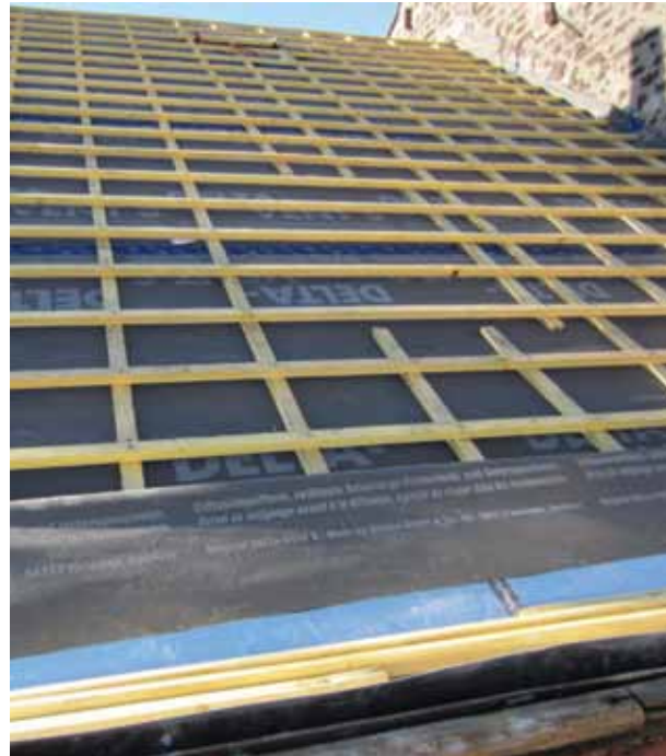
Refonte de la toiture avec pare-pluie HPV, contre-litonnage, litonnage et nouvelle tuile avec tuile faitière ventilé.
