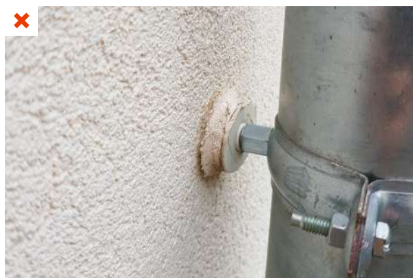
La fixation du collier dans l'ITE est légèrement arrachée et bouge. L'étanchéité à l'eau et le maintien de la gouttière ne sont plus assurés. ©AQC
