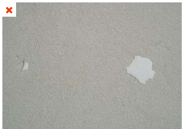
L'enduit du mur support de l'ITE se décolle. La préparation du mur par piquage n'est pas prévue.
