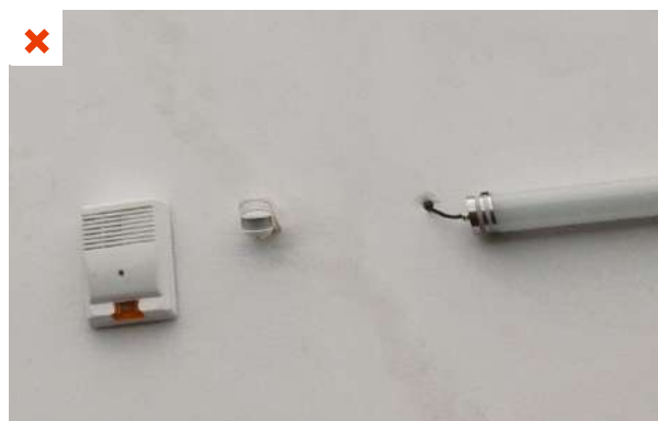
La gaine électrique alimentant la lumière extérieure traverse la paroi isolée et le support de l'ITE. Ce percement, réalisé après la livraison, n'est étanche ni à l'air ni à l'eau. ©AQC
