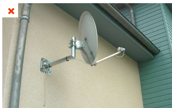
Une antenne parabolique a été installée après la réception de l'ITE. Le fil traverse l'ITE et le mur support. L'étanchéité à l'air du mur support et l'étanchéité à l'eau de l'ITE sont dégradées. ©AQC
