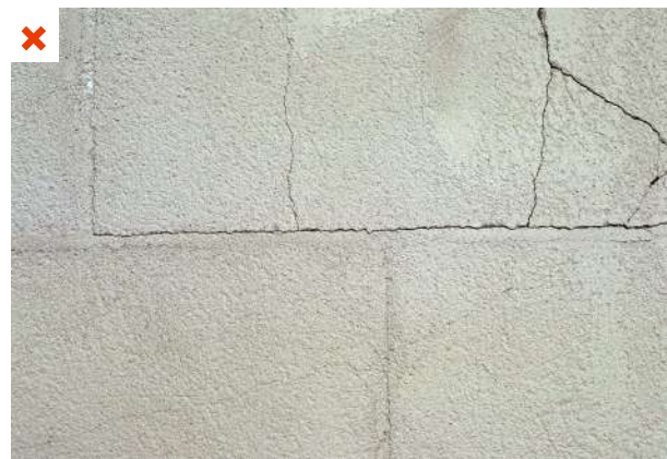
Le support de l'ITE présente des lézardes traversantes. La tenue mécanique de l'isolant par chevilles ne peut être assurée.
