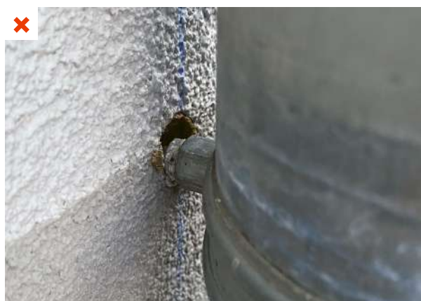
Les fixations des descentes d'eau pluviale traversant l'ITE ne sont pas adaptées. La tenue mécanique insuffisante entraîne une dégradation de l'isolant et la création d'un pont thermique. L'étanchéité à l'eau n'est plus assurée. ©AQC
