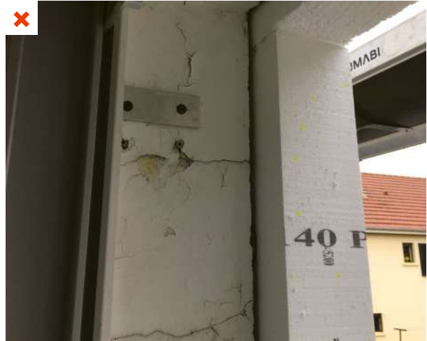
Le revêtement du tableau de fenêtre présente des décollements importants et des lézardes. Or l'isolant en polystyrène est fixé uniquement par collage à cet emplacement.
