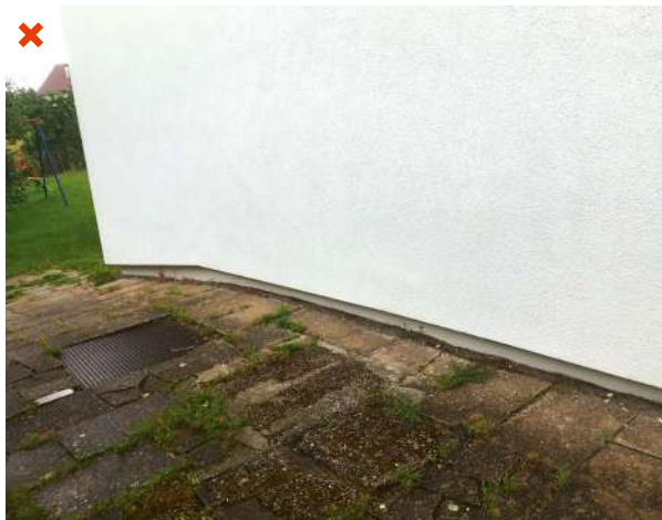
L'absence d'isolation des soubassements crée un pont thermique au niveau de la dalle basse. ©AQC
