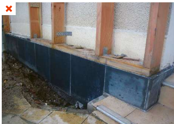
Le soubassement a été isolé avec des panneaux de liège et recouvert d'un parement de protection. Les marches en béton n'ayant pas été désolidarisées, elles créent un pont thermique. ©AQC
